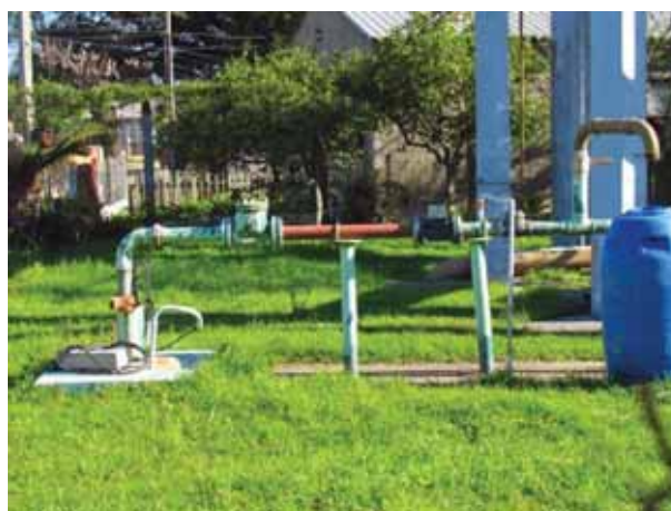
Figura 7.234: Poço tubular existente para abastecimento público na localidade de Povo Novo. Coordenadas UTM do ponto: 376.689 E / 6.466.145 N
