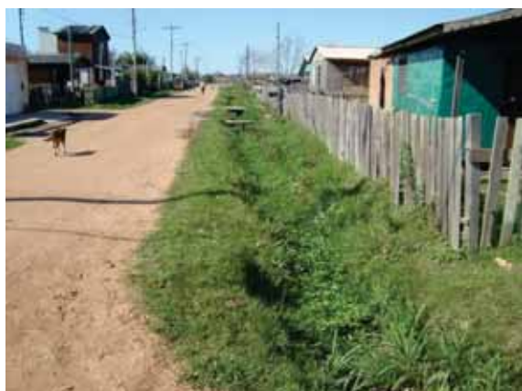
Figura 7.116: Vista de canal pluvial com esgoto a céu aberto na localidade da Quinta. Visada no sentido sudeste a partir de arruamento interno na própria localidade. Coordenadas UTM Fuso: 380572 E/ 6451538 N
