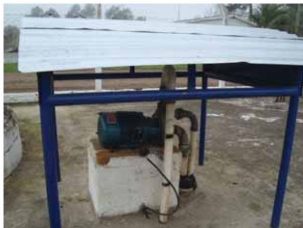
Figura 7.232: Poço tubular para uso industrial na Granja Quatro Irmãos. Coordenadas UTM do ponto: 364.308 m E / 6.437.095 N
