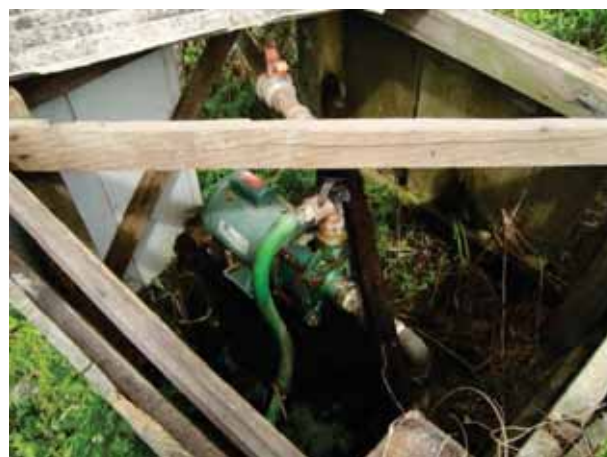
Figura 7.230: Detalhe do equipamento de captação de água subterrânea na localidade de Capão Seco. Coordenadas UTM do ponto: 374.140 E / 6.474.949 N
