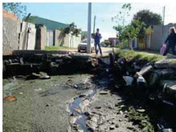
Figura 7.106: Vista de emissão de esgoto doméstico e pluvial na Rua Capitão Lemos de Farias localizado no Saco da Mangueira, na Vila Sardinha. Coordenadas UTM: 396823 E/ 6453621 N
