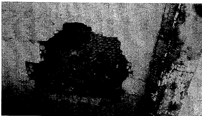
Foto 03 : Abertura na alvenaria na fachada para acesso ao interior prédio, deve ser fechado.
