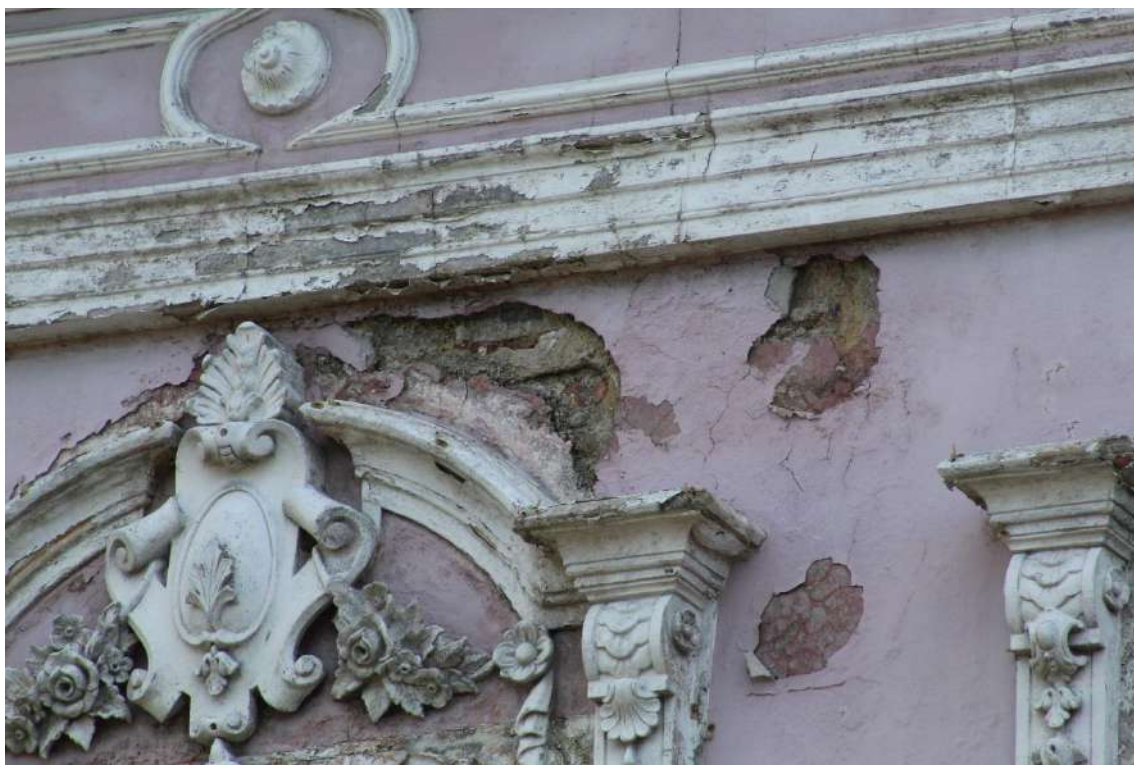
FACHADA LESTE: deslocamento do reboco | fissuras na cimalha e na argamassa de revestimento da alvenaria.
