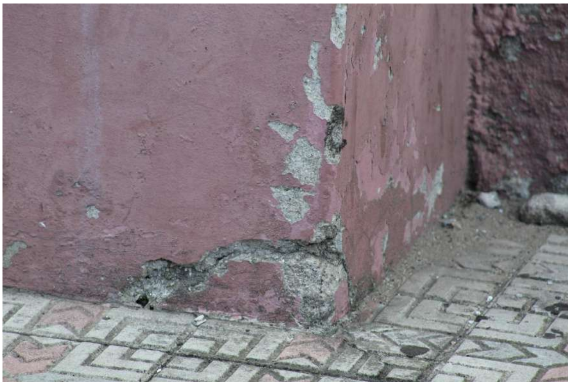
FACHADA LESTE: avarias no revestimento da base dos pilares
