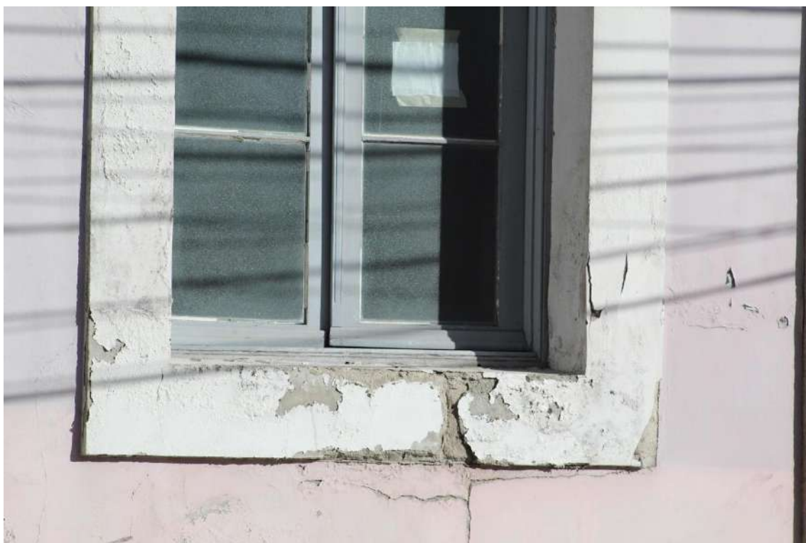
FACHADA NORTE: diversas avarias na moldura da esquadria 16
