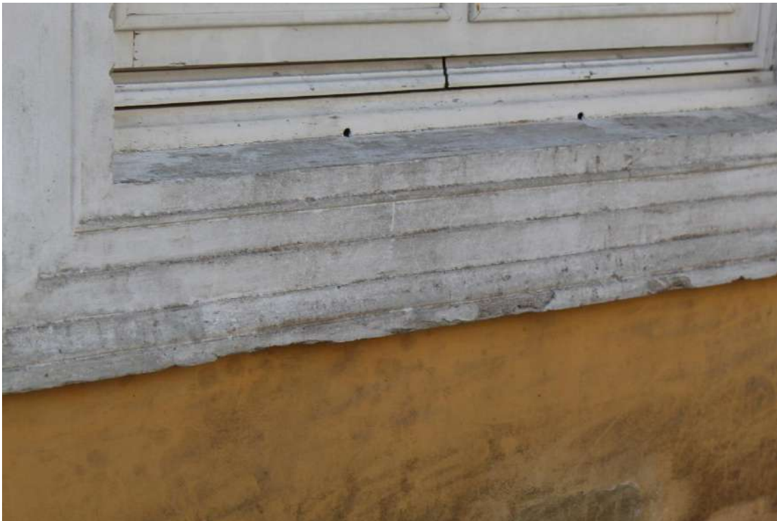
FIGURA 23 = FACHADA SUDESTE: moldura de argamassa avariada
