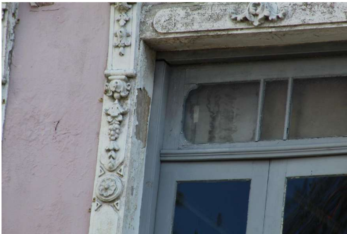
FACHADA LESTE: estufamento da pintura da fachada e dos ornamentos.
