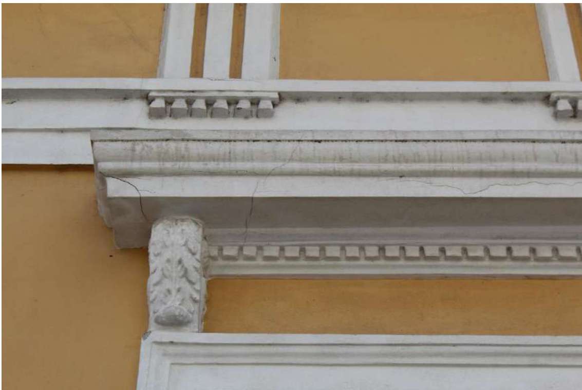
FIGURA 22 = FACHADA SUDESTE: fissuras na argamassa do ornamento
