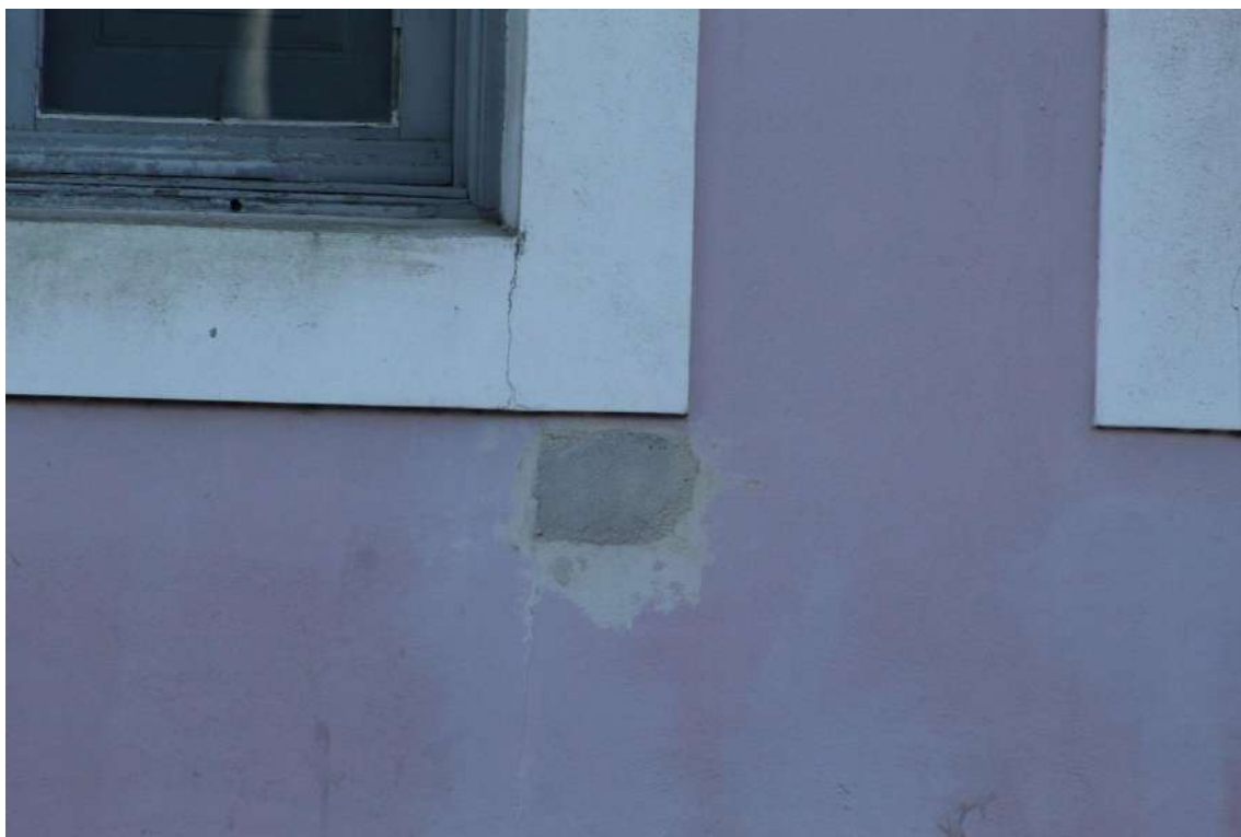
FACHADA LESTE: fissura superficial na moldura da janela | conserto com reboco de argamassa de cimento
