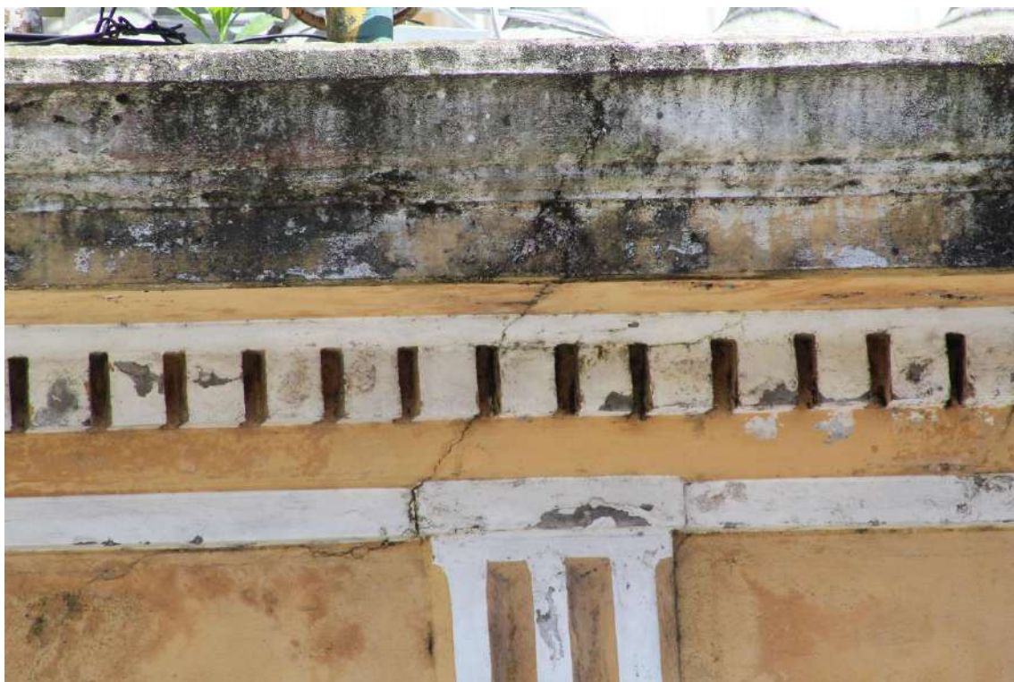
FIGURA 08 = FACHADA NORDESTE: fissura no reboco do parlatório.
