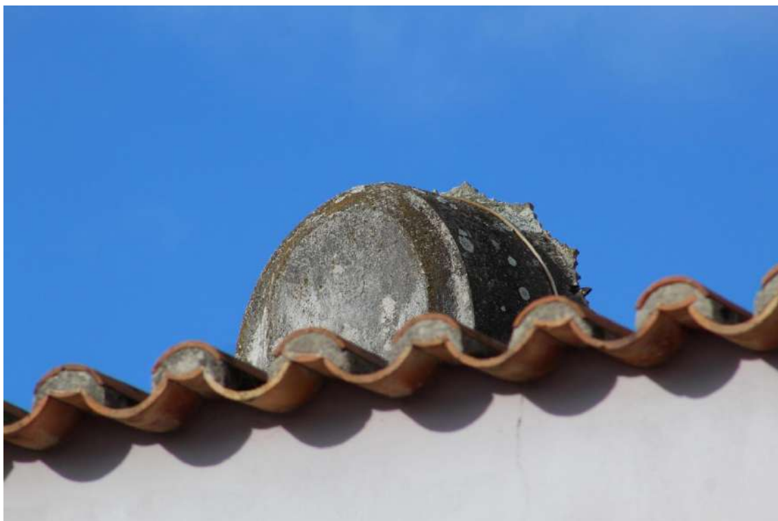
FACHADA SUL: sujidade e eflorescências na parte de trás do brasão da Fachada Leste | cordão de iluminação decorativa
