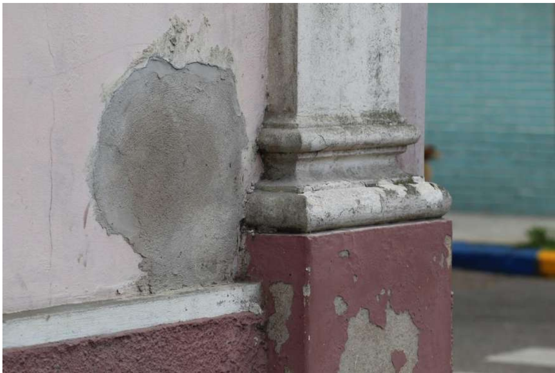
FACHADA LESTE: conserto com reboco de argamassa de cimento | descascamento da pintura
