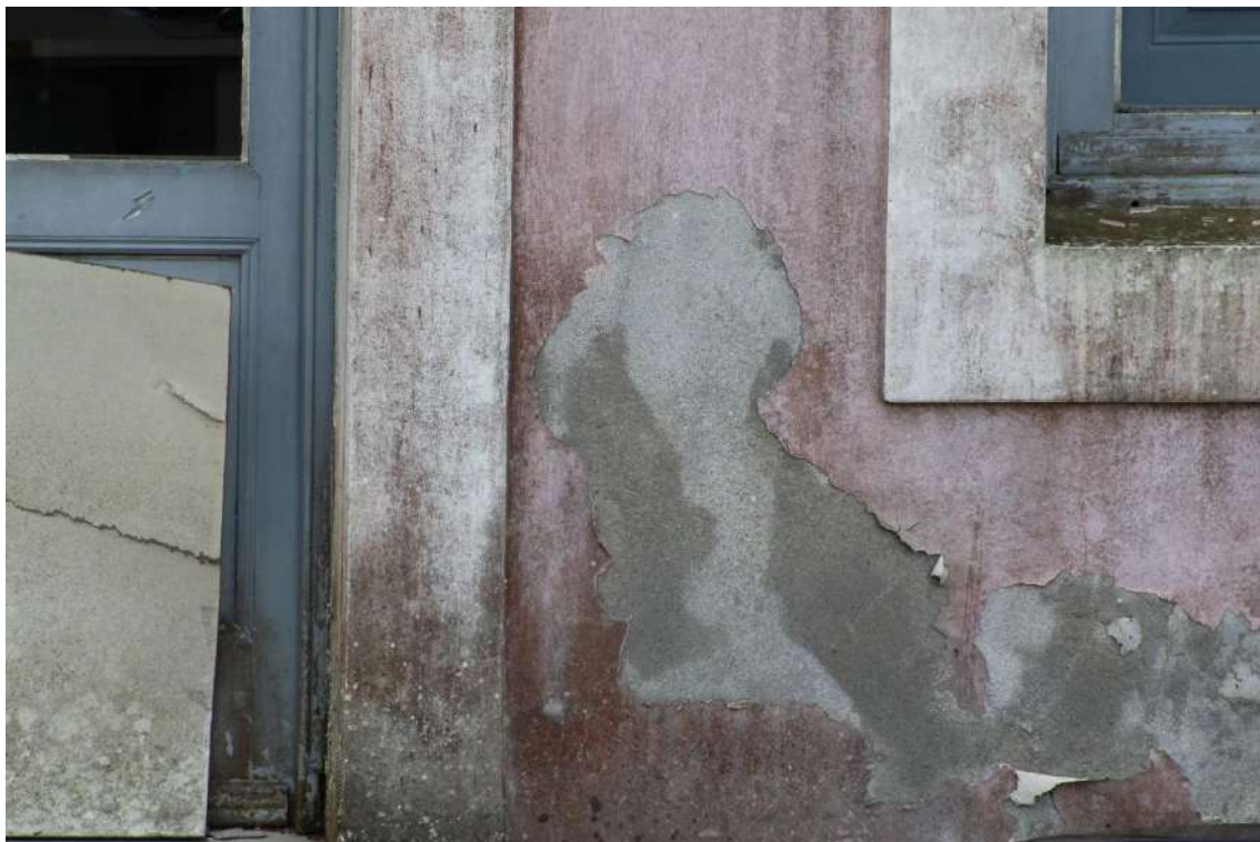
FACHADA SUL: descascamento da pintura
