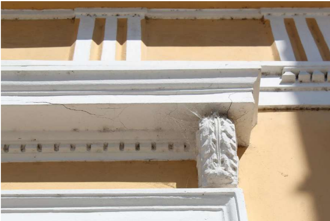
FIGURA 15 = FACHADA NORDESTE: fissuras na argamassa do ornamento
