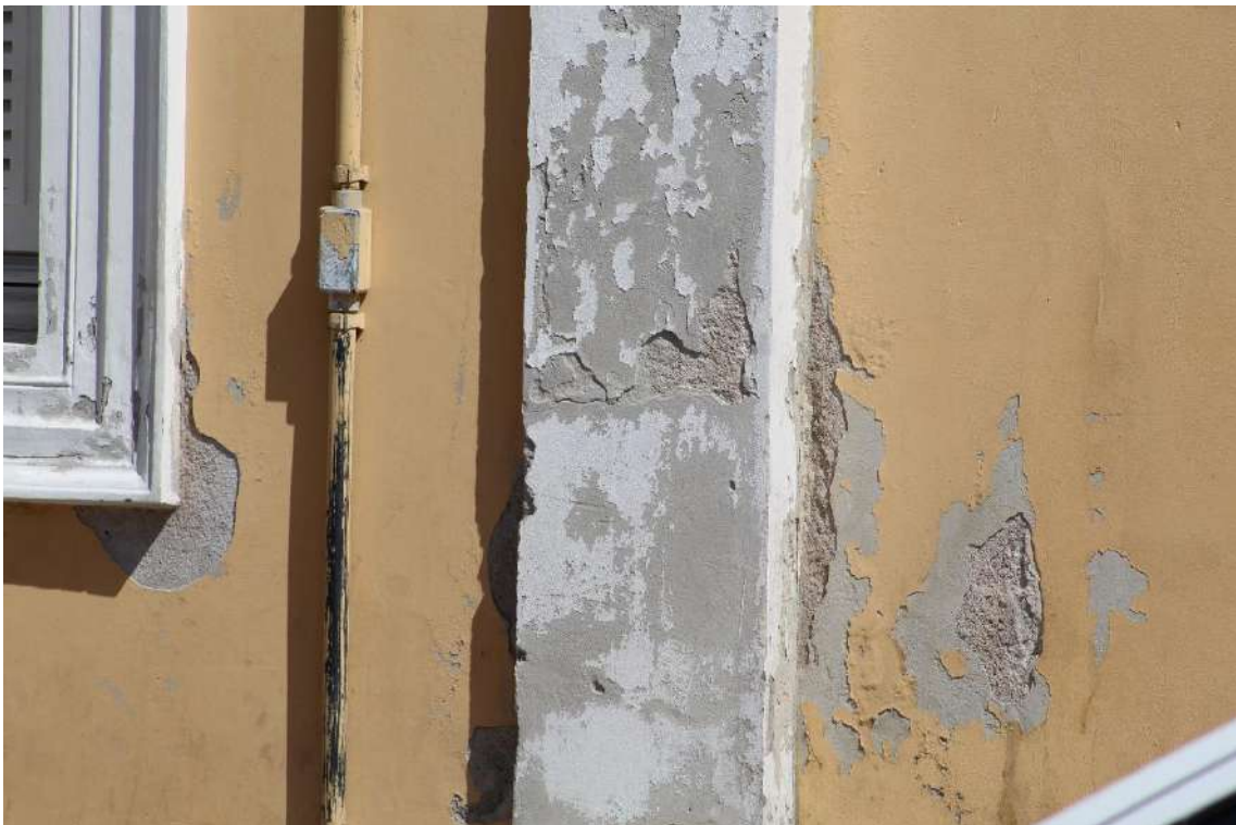
FIGURA 04 = FACHADA NORDESTE: pontos de deslocamento do reboco.
