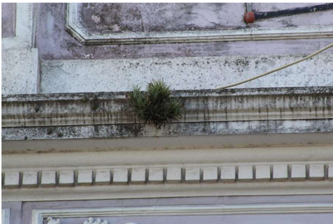
FACHADA LESTE: vegetação a ser removida
