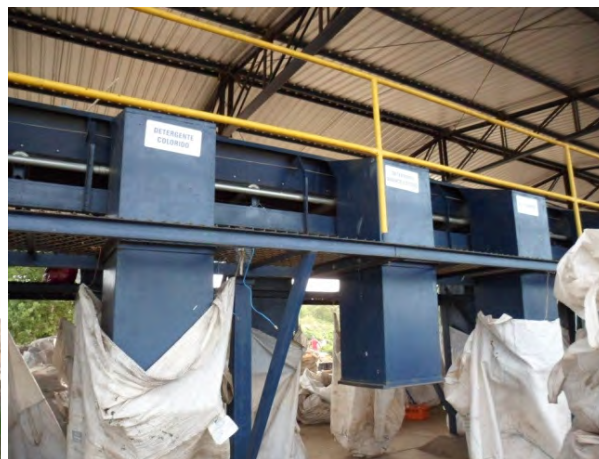
Figura 4.30: Detalhe da esteira e das embalagens para armazenamento dos resíduos triados
