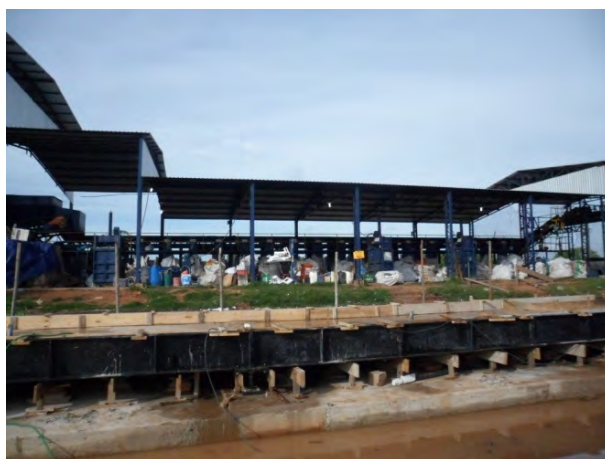
Figura 4.31: Vista geral da esteira de triagem
